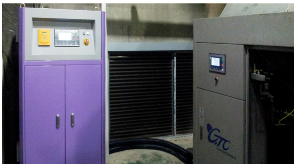
VSD+ 100마력 적용 현장
